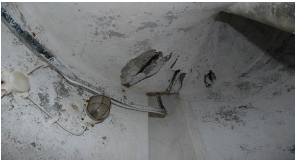
Εικόνα 6: Διάβρωση στοιχείων σκυροδέματος (αποκόλληση επικαλύψεων, οξείδωση σιτισμού)
