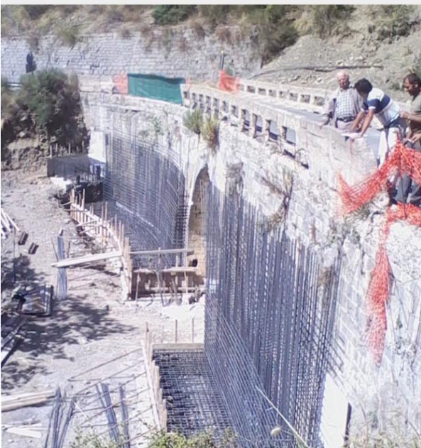
Εικόνα 2: Φωτογραφίες του γεφυριού πριν (πάνω) και μετά την εξέλιξη των εργασιών διαπλάτυνσης (πηγή κάτω φωτογραφίας: © Κανέλλος Γιαννικόπουλος, https://lagkadia-lagkadia.blogspot.gr , 2017)
